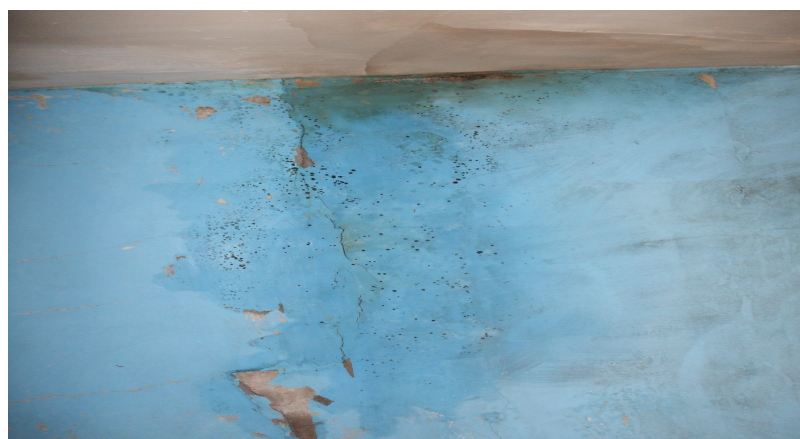
Infiltrations d'eau dues à une fuite au niveau d'une cheminée
