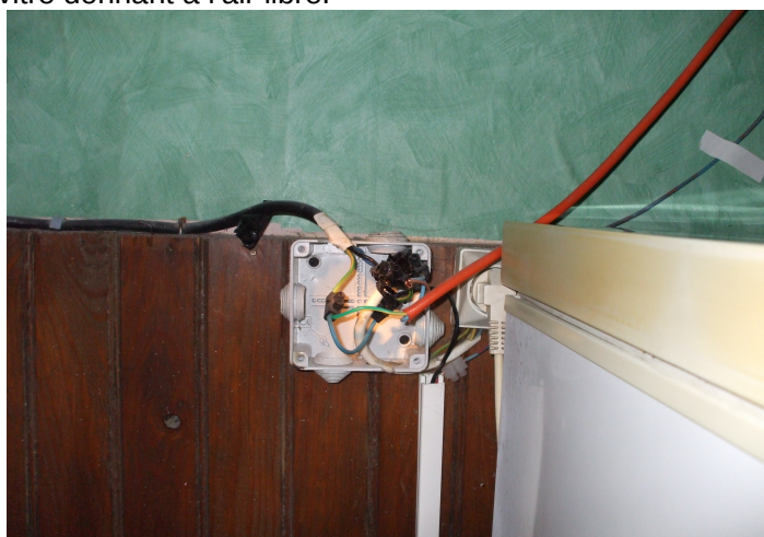
Installation électrique dangereuse
