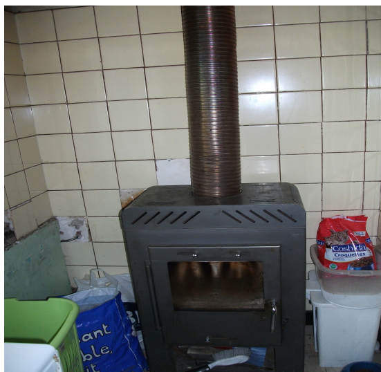
Installation de chauffage inadaptée à la taille du logement
